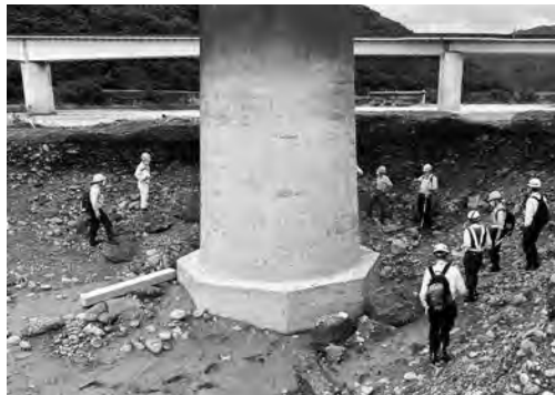
写真② 球磨川橋りよう橋脚：最下部まで洗掘が進んでいた
